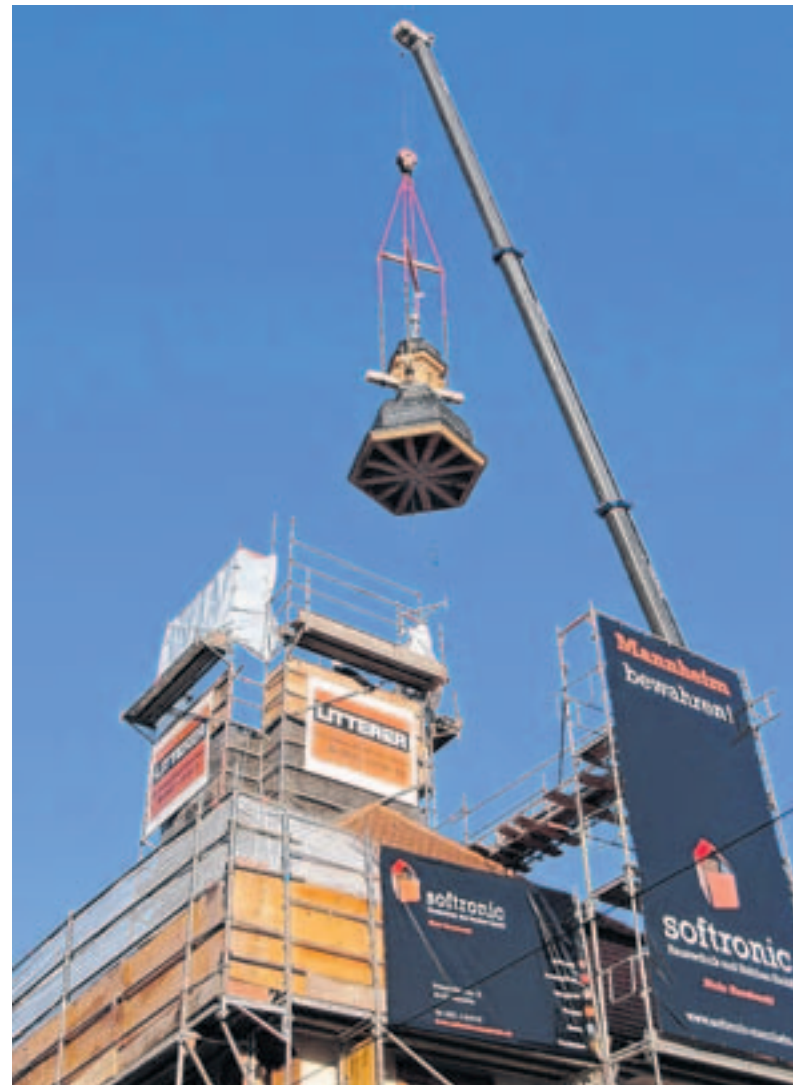
Am Haken eines 130-Tonnen-Krans schwebt der restaurierte Turmhelm des historischen Seckenheimer Rathauses an seinen Platz.
